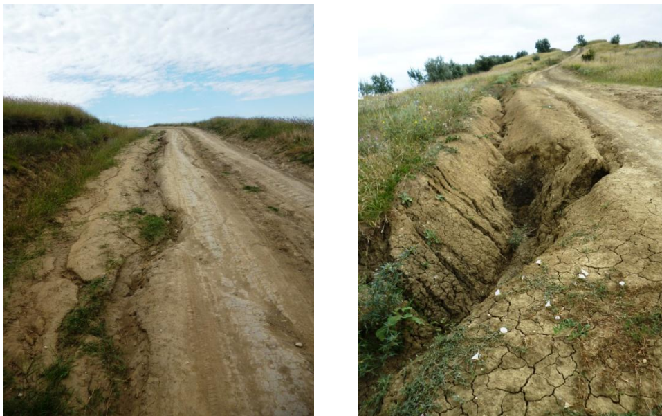
Fig. 29 Rigole și ogașe formate în zona drumurilor pe versanții vestici ai bazinului Larga
