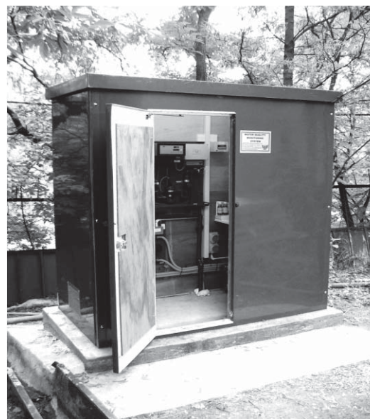
Fig. 4.7. Stație automată de control a calității apei amplasată pe râul transfrontalier Prut.
